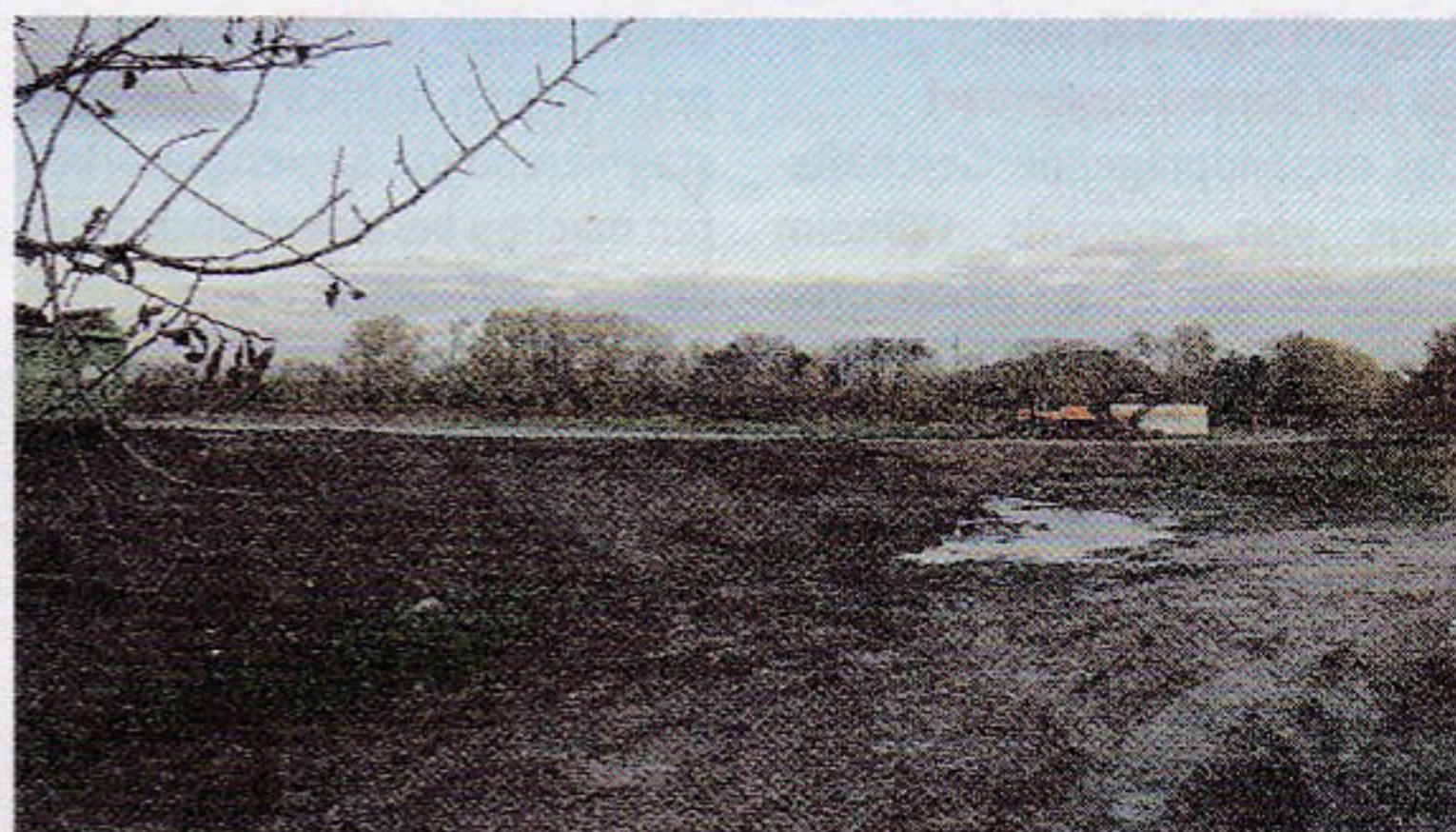
Zehn Jahre nach dem sich der Rat mehrheitlich für den Autohof Ellens entschieden hat, haben jetzt die Bauarbeiten begonnen.
